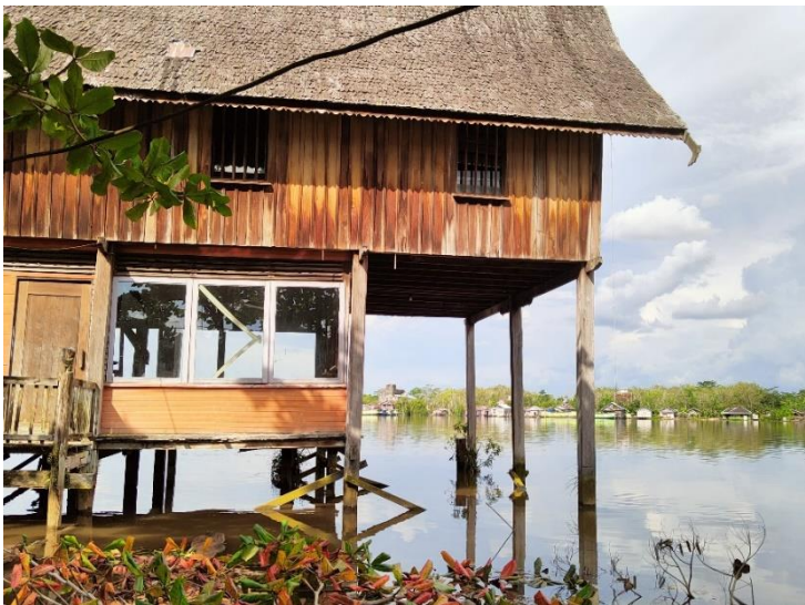
Gambar 5. Kondisi tiang kayu di pinggir sungai
