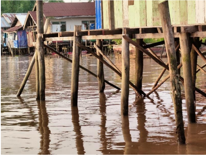
Gambar 6. Kondisi tiang kayu di pinggir sungai
