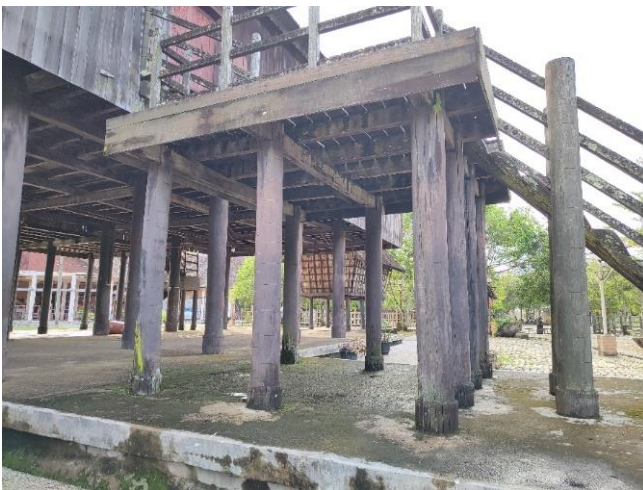
Gambar 7. Kondisi tiang kayu besar di tanah rawa
