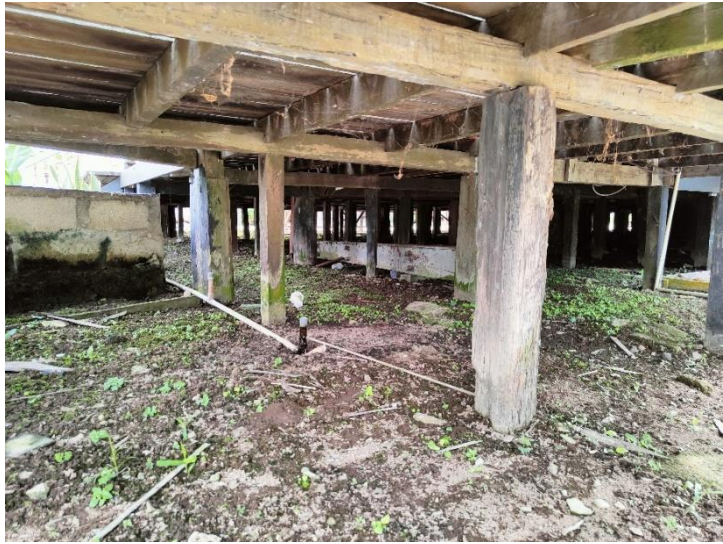
Gambar 4. Kondisi tiang kayu di rawa kering
