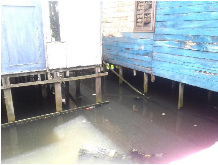
Gambar 2. Kondisi pondasi di rawa berair
