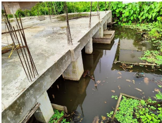
Gambar 3. Kondisi pondasi tiang beton di rawa berair
