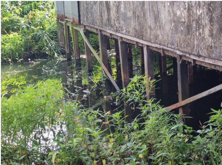
Gambar 1. Kondisi pondasi tiang kayu di tanah rawa
