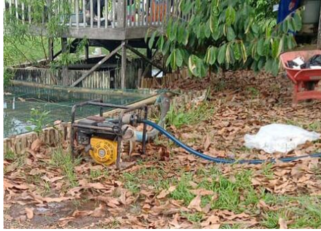
Gambar 3.5 Mesin Pompa Air
